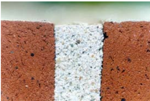
Oorspronkelijke voeg. Original joint.
